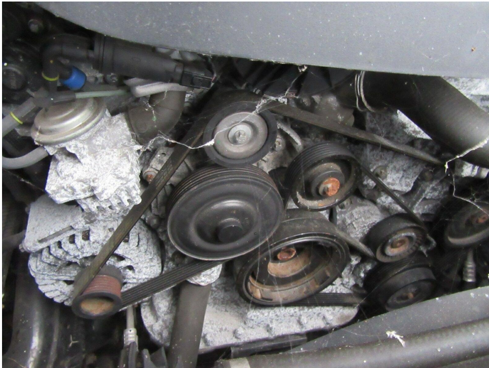
Bild 17 : Motor und Getriebegehäuse stark korrodiert- reinigen
